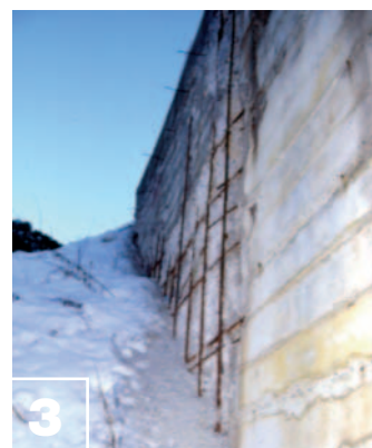
Fig. 3 Degrado della struttura in clima esposto ai cicli di gelo-disgelo (da "Il Nuovo Calcestruzzo" - Terza Edizione, Ed. Tintoretto, Villorba 2004).
