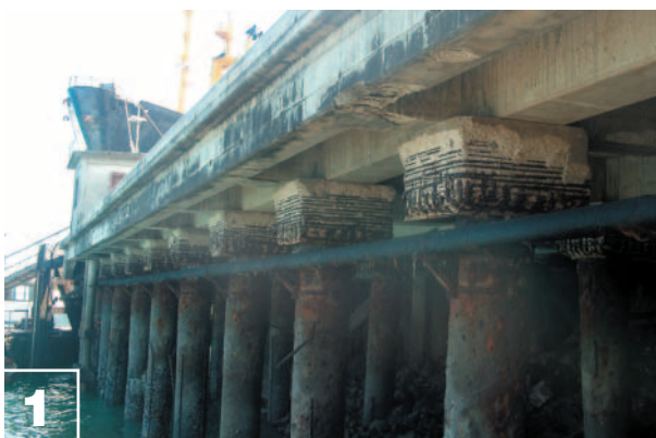
Fig. 1 Degrado della struttura per corrosione dei ferri di armatura in ambiente marittimo (da "Il Calcestruzzo Vulnerabile: Prevenzione, Diagnosi del Degrado e Restauro", Ed. Tintoretto, Villorba 2004).
